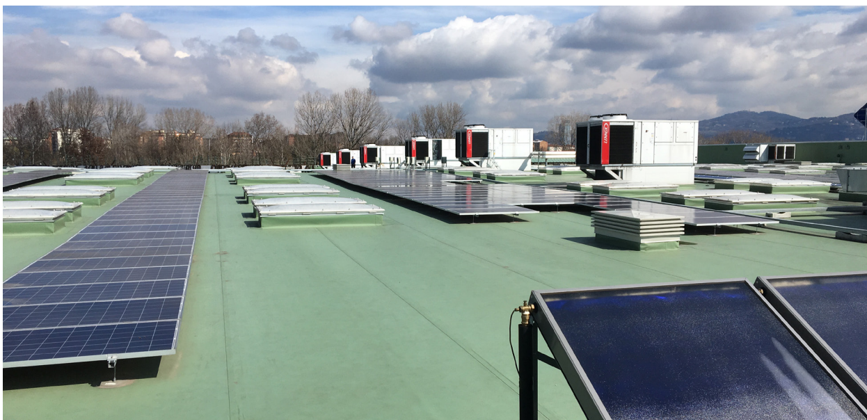
Esempio di posizionamento su tetto piano di pannelli fotovoltaici e collettori solari performanti
